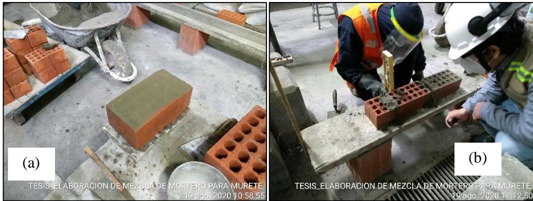
Figura 16. (a) Elaboración de cama de mortero para la unidad de albañilería en contacto con la escuadra de carga; (b) Asentado de ladrillo para elaboración de muretes.
