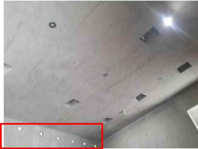
Figura 119. Presencia de vanos laterales en los muros para generar ventilación cruzada Fuente: Elaboración propia, 2019
