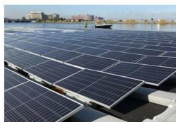
Uso de paneles solares fotovoltaicos
