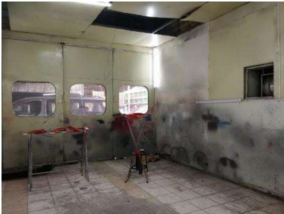
Figura 39: Cuarto de pintado en mal estado. Fuente: Galería propia de imágenes.
