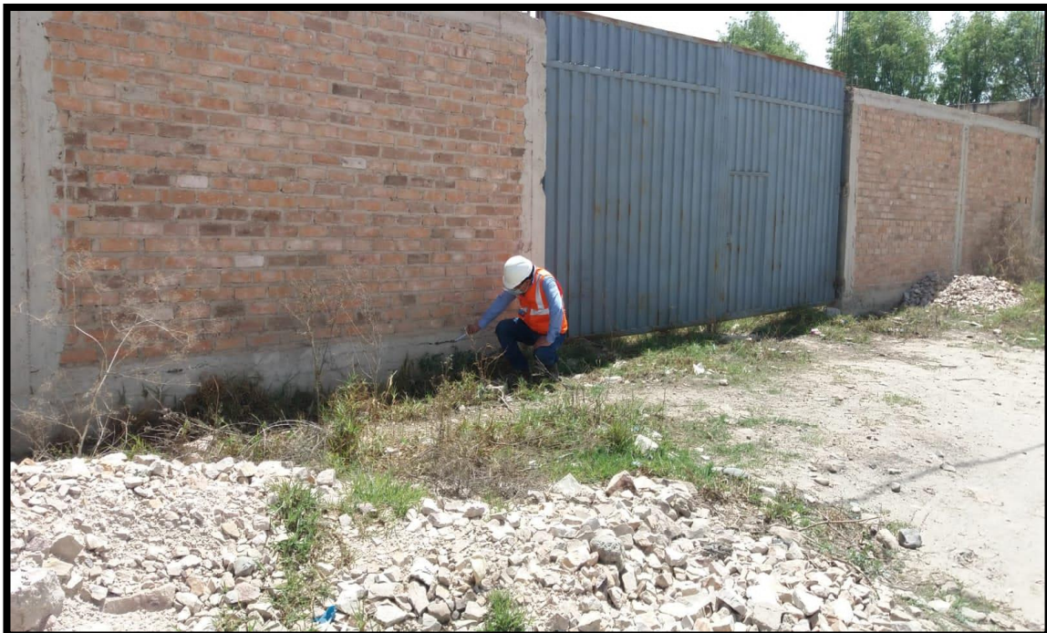
Figura 18 Fisura en la estructura
