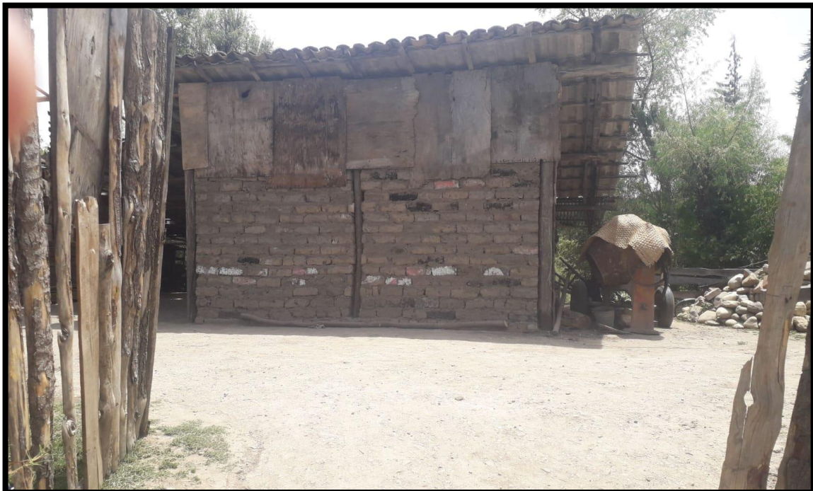
Figura 26 Viviendas autoconstruidas de con material de baja calidad
