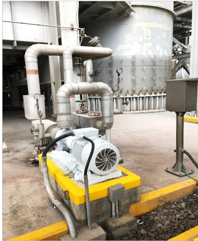
Figura 29: Bomba CPH del HRSG de la Central Termoeléctrica Kallpa.
