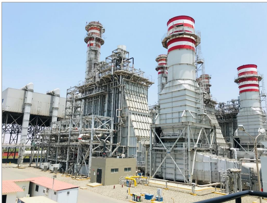
Figura 14: Foto panorámica del HRSG de la Central Termoeléctrica Kallpa,
