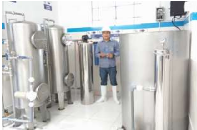
Figura 9. Proceso de filtración de agua. Fuente: Empresa GRUPO EJ S.R.L.
