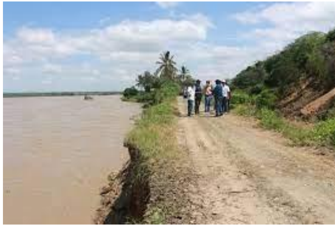
Figura 4. Erosión del canal Miguel Checa Fuente: cutivalu.pe
