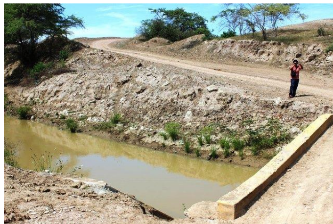
Figura 9. Deterioro del canal Miguel Checa Fuente: elregionalpiura.pe (2015).
