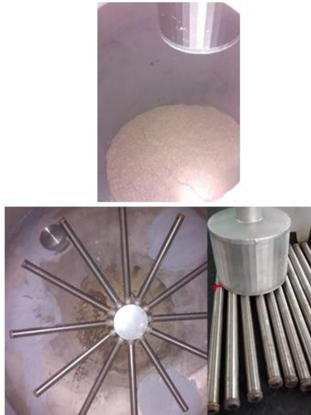
Figura 55. Ensamble de tanques de filtro de Grava, Arena y carbón activado.
