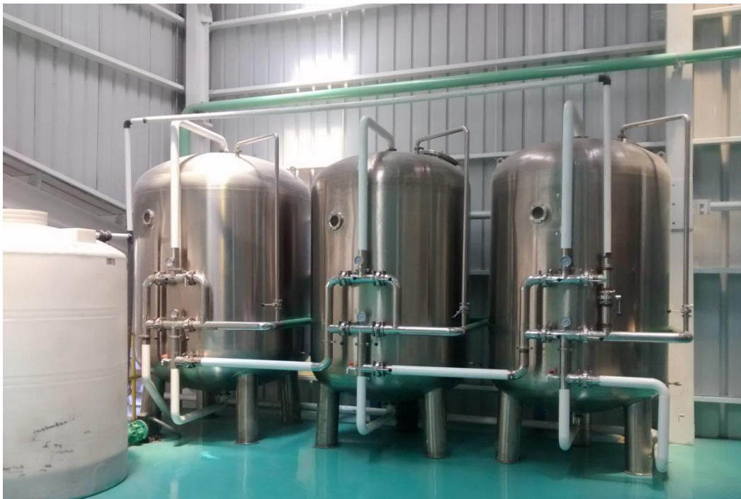
Figura 60. Ensamble terminado de tanques de filtro de Grava, Arena y carbón activado.
