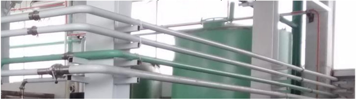
Figura 46. Tuberías de 2" y 3", para utilizarlas para las interconexiones con las bombas.
