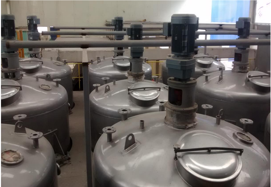
Figura 14. Reactores, Pendientes para su Interconexión a Proceso
