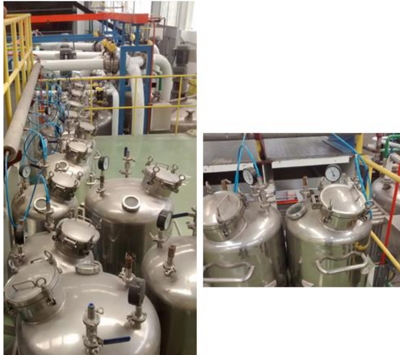
Figura 34. Conexión De tubería de Aire para el Suministro a tanques Enzimáticos
