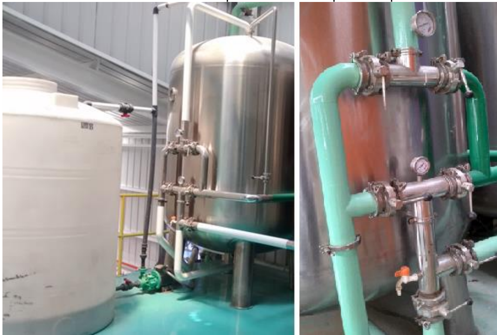
Figura 57. Ensamble de tuberías desde el tanque de limpieza CIP.
