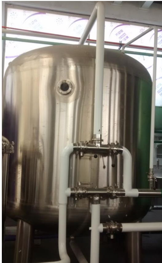
Figura 47. Tanque filtro de arena de 10m 3 para ser reubicados.
