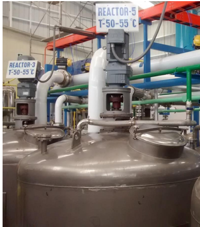
Figura 17. Reactores, Culminados en la Interconexión a Proceso
