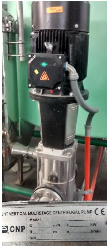
Figura 44. Bomba de alimentación hacia tanques de filtros de Arena.
