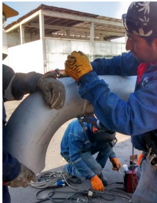
Figura 52. Ensamble de tuberías para la recolección de los condensados.
