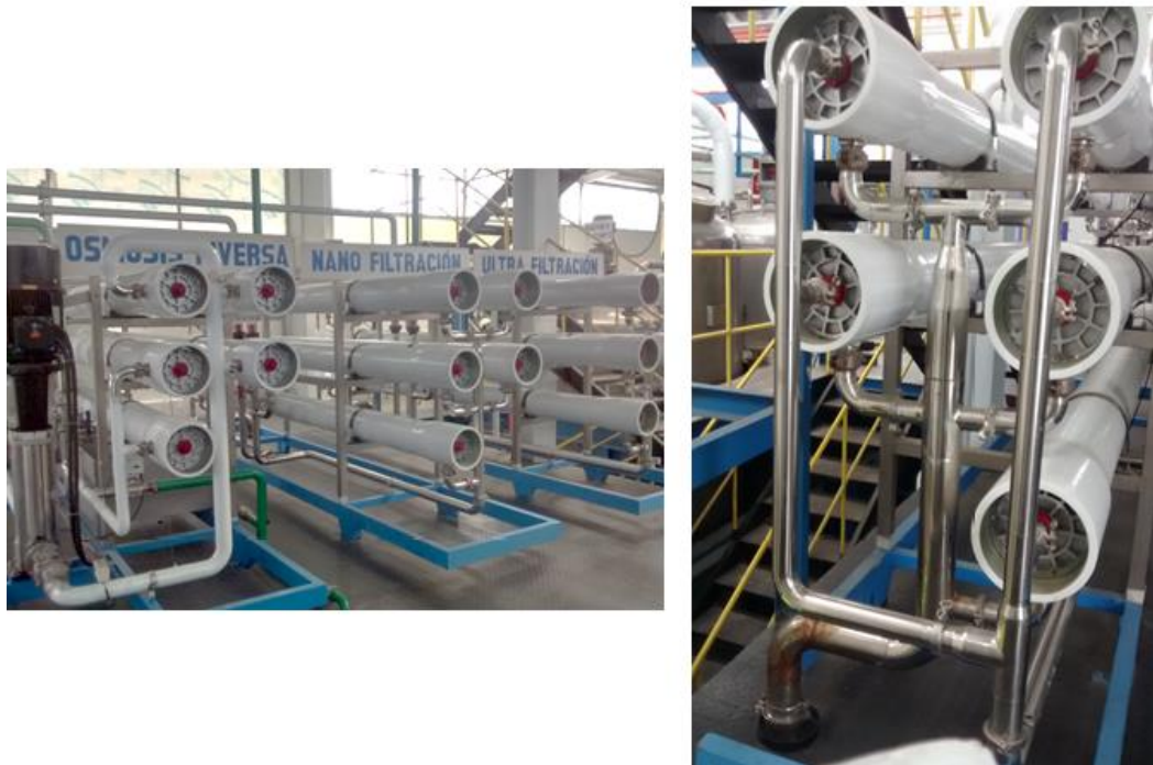
Figura 35. Conexión De tuberías de Solubles entre los filtros de 30Kda y Osmosis
