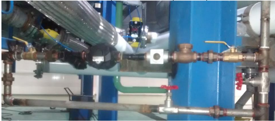
Figura 19. Trampas de Vapor Instaladas en cada Reactor
