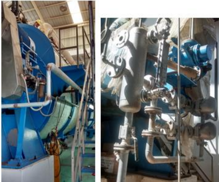
Figura 36. Conexión De tuberías de Vapor de Secador RCD y Trampas de Vapor
