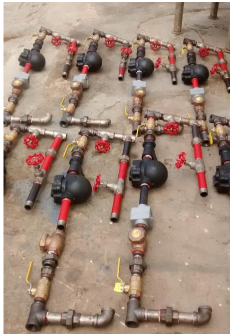
Figura 18. Armado de las Trampas de Vapor
