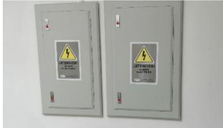
Figura 87. Ubicación de Tableros Eléctricos
