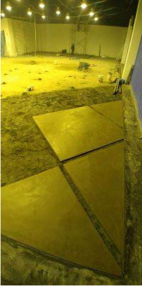
Figura 73. FOTO OBRA TEATRO - Vaciado y nivelación de piso según diseño en planos
