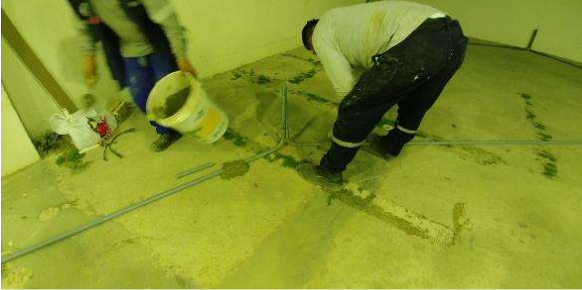
Figura 64. FOTO OBRA TEATRO - Colocación de tubería de pvc para cableado eléctrico en piso
