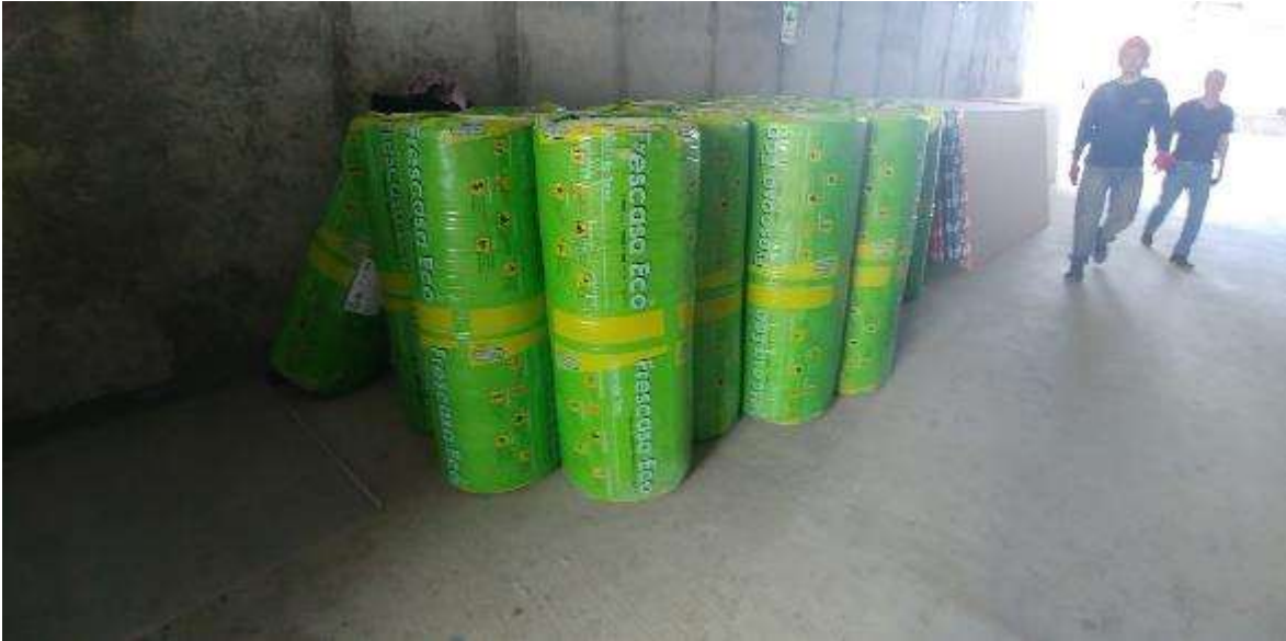
Figura 79. FOTO OBRA TEATRO - Acarreo de material lana de vidrio para aislar ruido en tabiques de drywall
