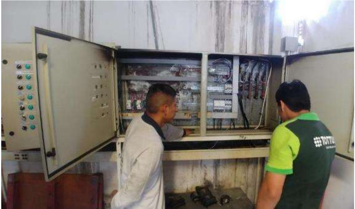
Figura 23. FOTO OBRA - Verificación y cambio de circuitos en tablero principal de tienda
