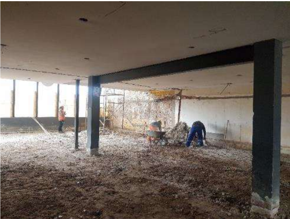
Figura 125. FOTO OBRA Tienda saludable - Limpieza de terreno de material producto del picado.
