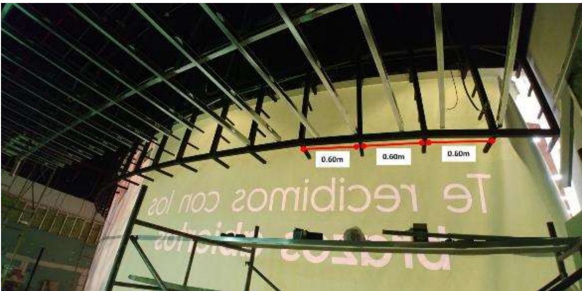
Figura 100. FOTO OBRA TEATRO - Instalación de riel para FCR de drywall en hall de ingreso
