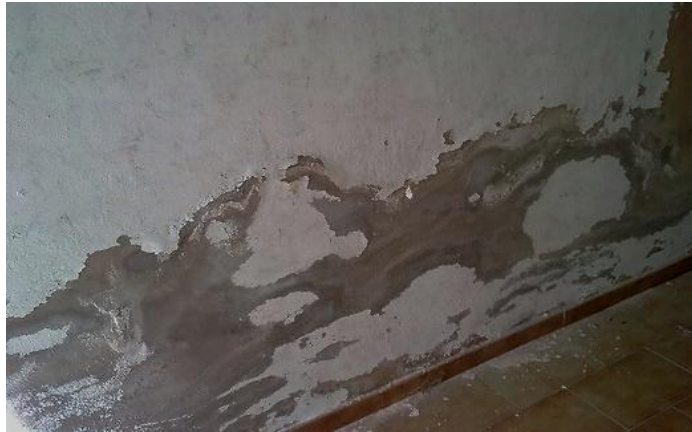
Figura 1. Desprendimiento de pinturas por efecto de humedad en tabiquería
