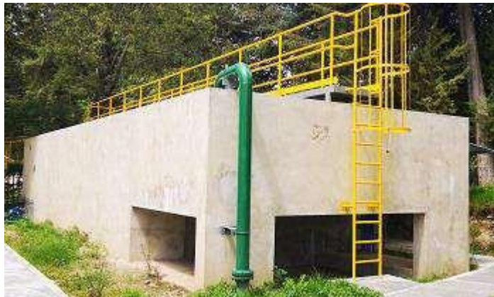
Estanque de cloración
