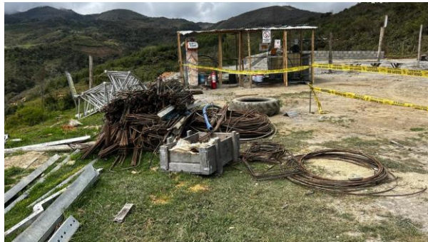
Figura 25 Falta de control de almacenamiento
