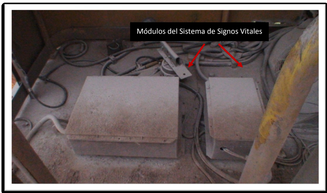
Figura N° 06. Cajas de nemas ubicadas en el techo de la perforadora Reedrill SKS-12
