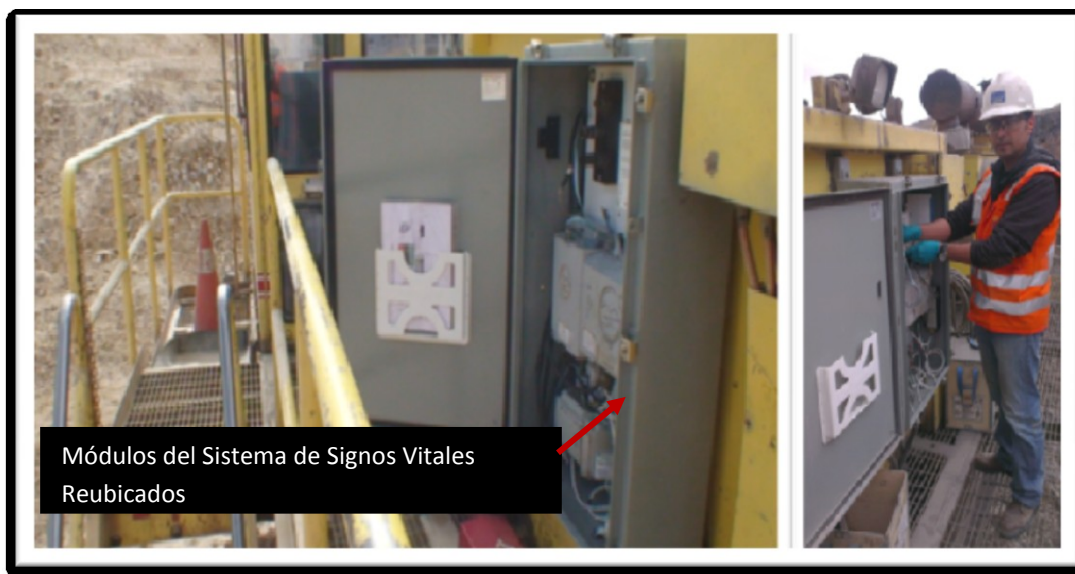
Figura N° 10. Caja nema reinstalada conteniendo los módulos: PLC, HUB y GSP de la perforadora Reedrill SKS-12.
