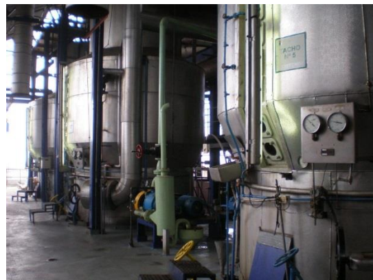
Foto (Área de centrifugas-Tachos)
