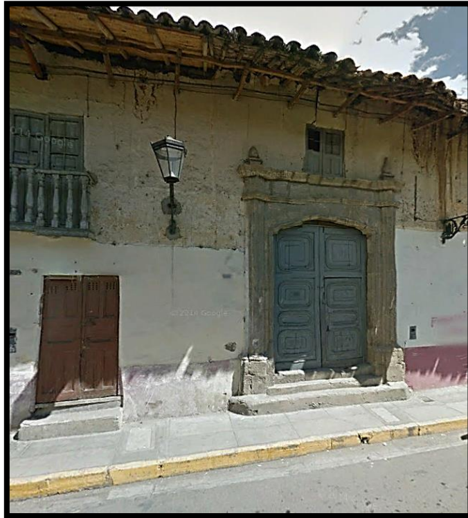
Fig.1: Fachada de casona afectada por factores ambientales.
