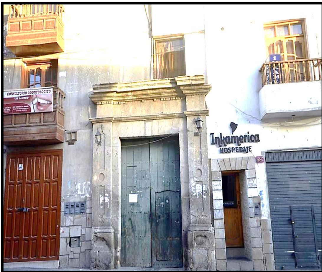
Fig.3: Casona afectada en su estructura por la expansión distorsionada de los edificios aledaños.
