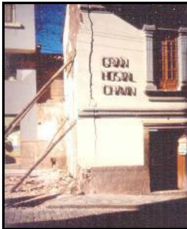
Fig. 44: Grieta vertical en esquina superior de muro que baja hasta muro de primer nivel.
