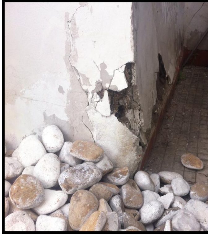
Fig.7: Asentamientos en muros.
