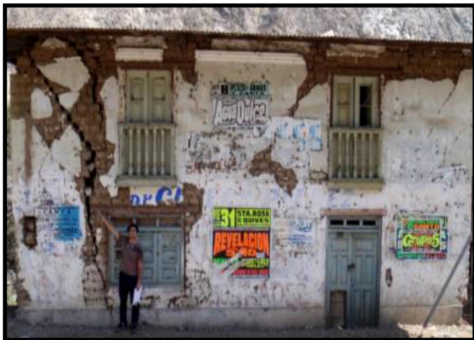
Fig. 45: Grieta por corte en el plano del muro.
