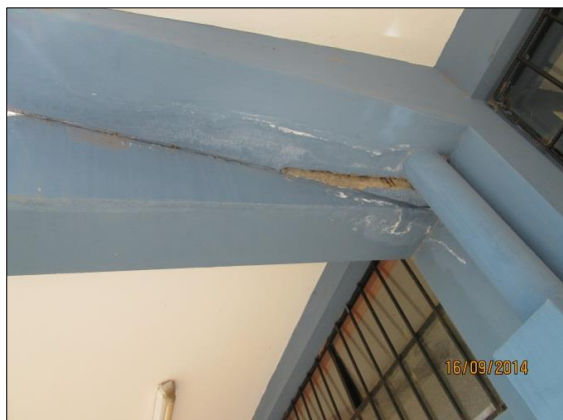
Humedad en vigas por mala instalación de tuberías
