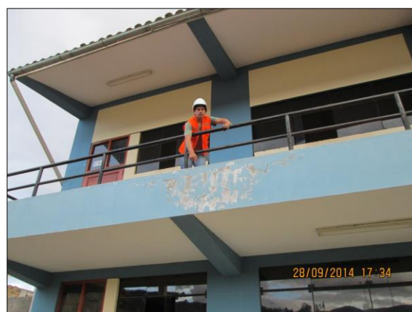
Humedad en losa y tabiquería
