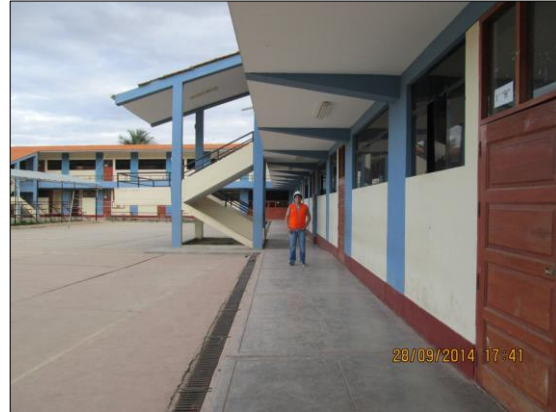
Grietas en tabiques
