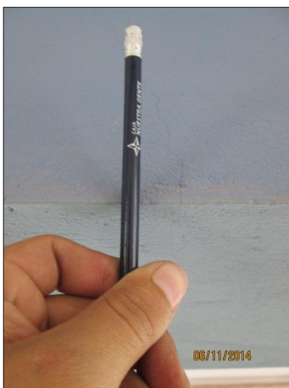
Fisuras en vigas principales
