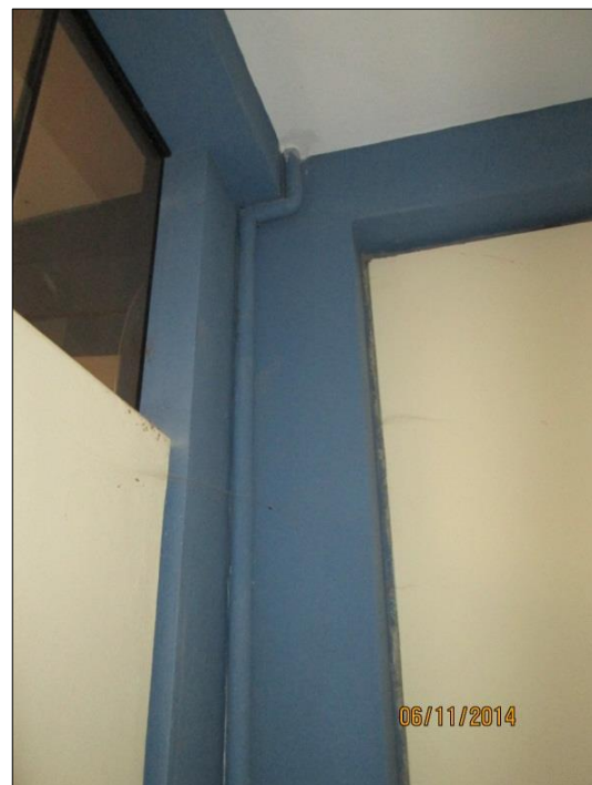
Tuberías que cruzan la losa
