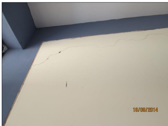
Fisuras en tabiquería
