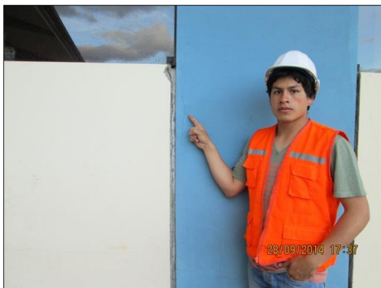
Fisuras tabiquería - columna
