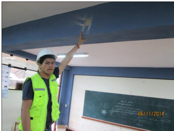
Muestra sin tarrajeo
