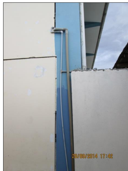
Mala colocación de tuberías de agua
