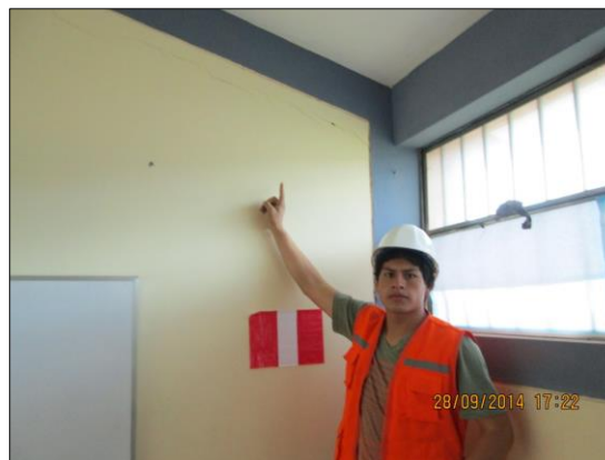
Fisuras en tabiquería
