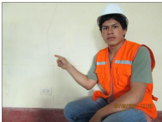
Fisuras en tabiquería
