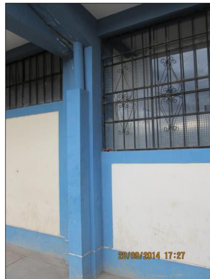
Mala instalación de tubería de desagüe
