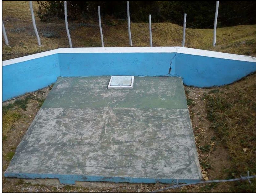
Captación Pajuro II
