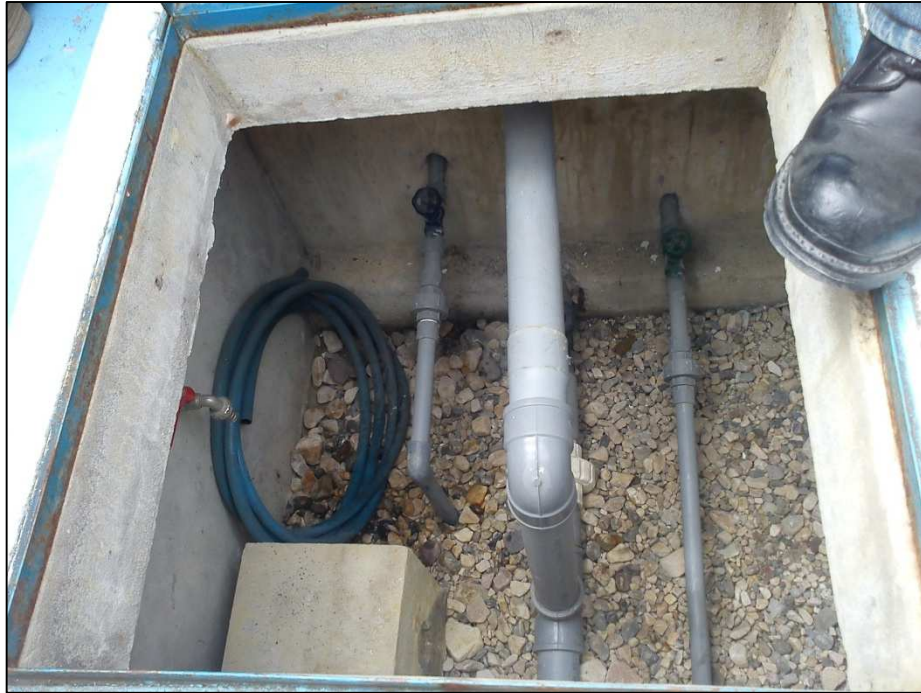
Caja de válvulas del sistema
