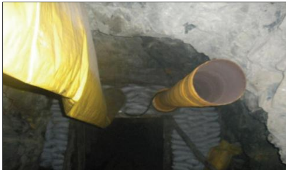
Foto 1: Mangas Y Ventiladores.
