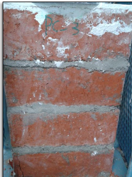
Figura N° 29. Falla de la pila PC-3.
