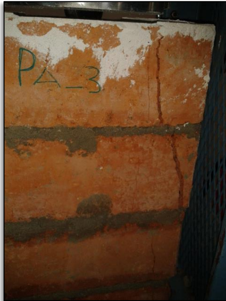
Figura N° 17. Falla de la pila PA - 3 (vista posterior).
