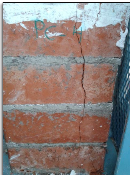
Figura N° 31. Falla de la pila PC - 4
