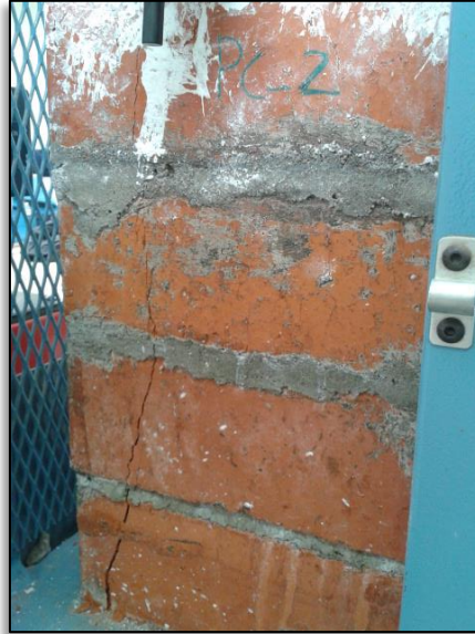
Figura N° 28. Falla de la pila PC-2.
