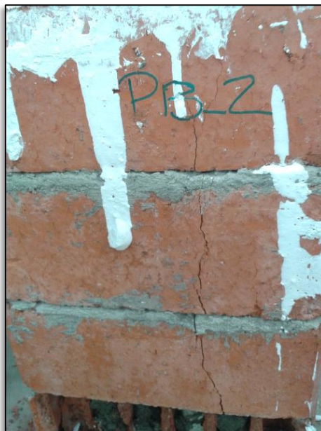
Figura N° 22. Falla de la pila PB-2 (vista posterior).
