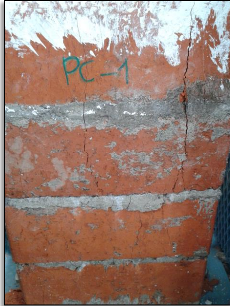
Figura N° 26. Falla de la pila PC-1.
