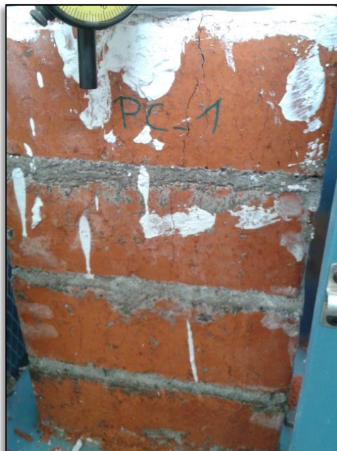
Figura N° 27. Falla de la pila PC-1. Parte posterior.
